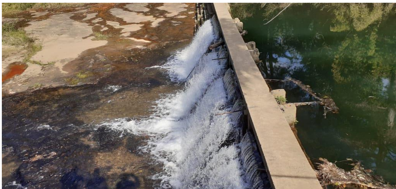
Figura 01 – Barragem Captação Rio Capivari
