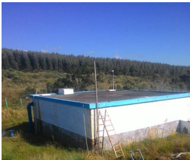
Figura 07 - Reservatório C2 - Três Bocas
