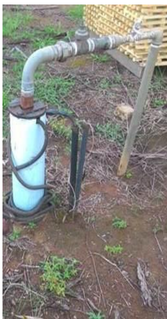
Figura 04 - Captação em poço profundo - Distrito Industrial II
